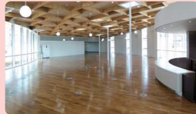
完成間近のパビリオン棟。急ピッチで最後の仕上げが行われています。
