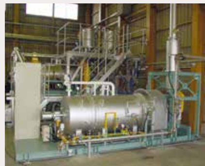
ボールキルン型のリサイクルプラント
