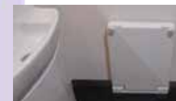
フィッティングボード (12か所)
