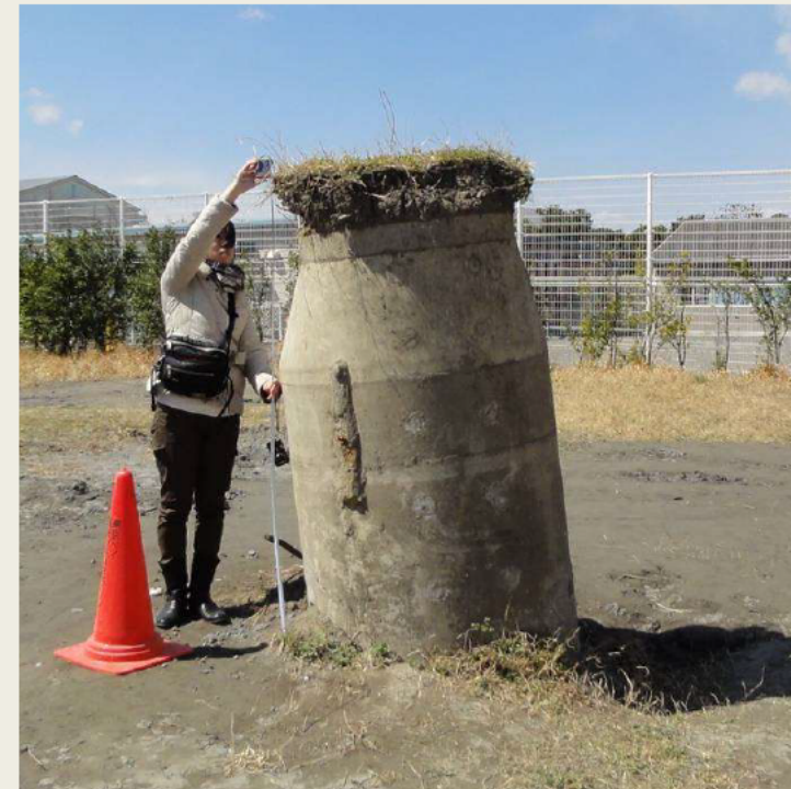
液状化により地表に飛び出したマンホール
